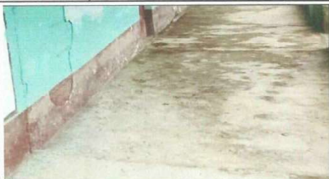
Foto1: Piso del aula del establecimiento donde se puede evidenciar la necesidad de sustitución de plancha de concreto a piso ceramica
